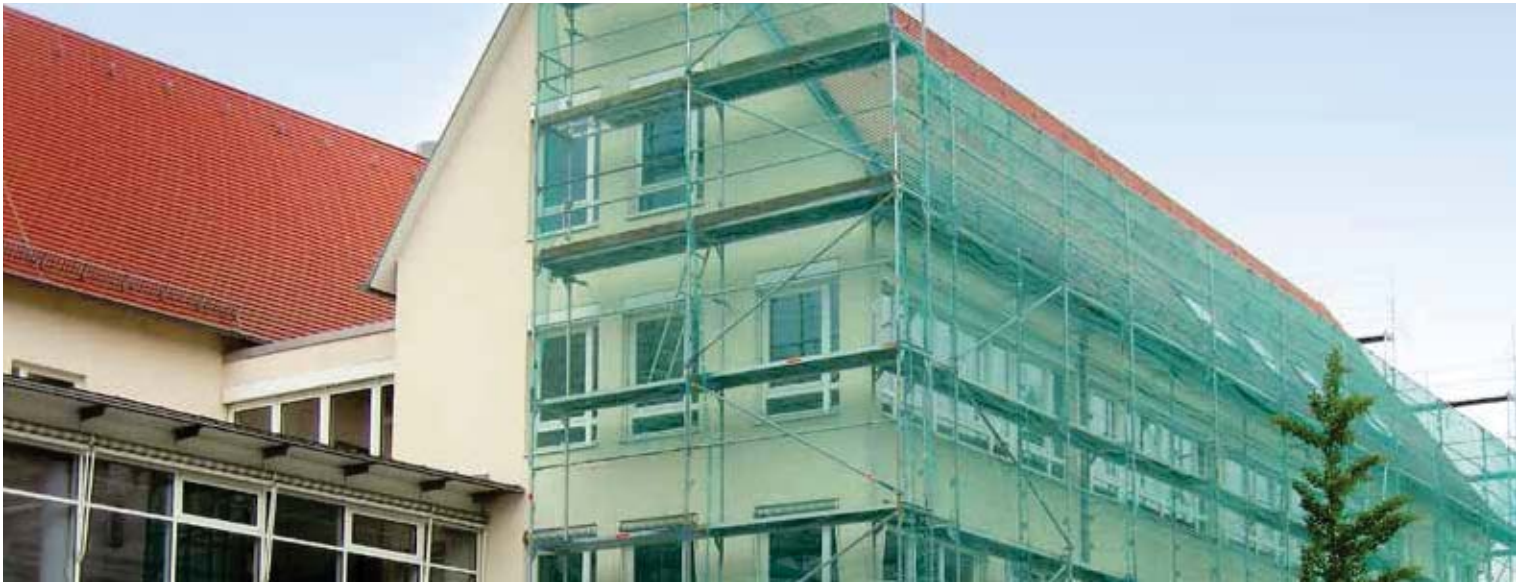
Abb. 1: Fassadengerüst mit engmaschigem Netz
