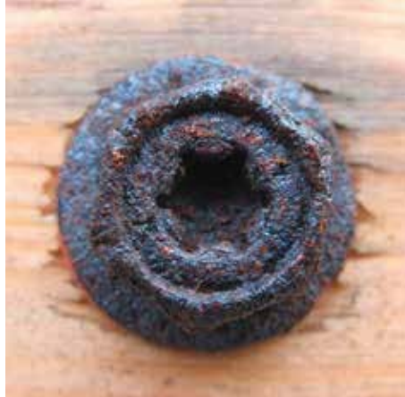
Abb. 6: In bauteilähnlichen Versuchskörpern auf der Insel Helgoland eingebaute und ausgelagerte Kunststoff-Rahmendübel mit Schrauben aus nicht korrosionsgeschütztem unlegiertem Stahl nach 2 Jahren [2]
